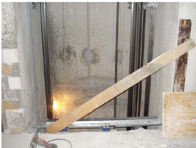
Slika C. 4: Nepravilno zavarovano dvigalo
