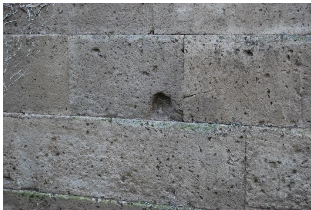
Slika 3. 4: Detajl poškodbe ozidja Pompejev
